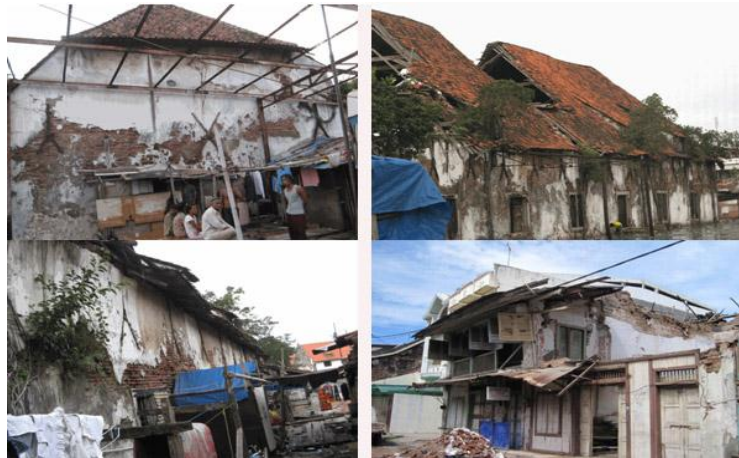
Foto. Kerusakan pada bangunan kuna di Kota Lama Padang pasca gempa tahun 2009
