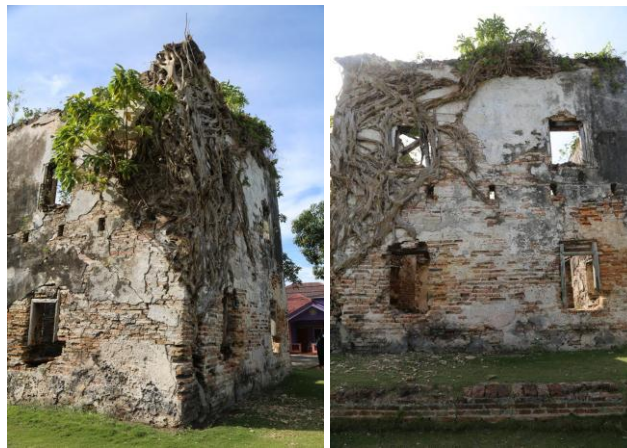
Foto. Akar yang tumbuh dan menutupi dinding pada bangunan Rumah Thabib di Tanjung Pinang (Dok. BPCB Sumbar, 2016)
