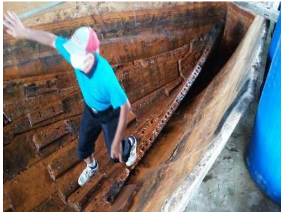
Pengecekan kebocoran mangkuk
