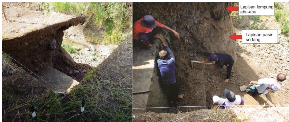
Foto 3. (kiri) Kondisi trench setelah longsor pada dinding timur. Pada bagian tengah merupakan material longSORan yang menutup trap ke-2 dan ke-3. (kanan) Proses pembersihan material longSORan di trap 2 dan 3 (Foto: Dian Nisa)
