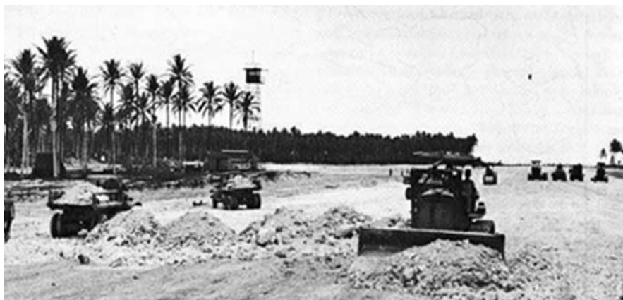
Proses pembuatan landasan pesawat terbang sekutu. Sumber http://ww2db.com/image.php?image_id=11682 Bandara sekutu di werur sausapor kab. Tambrau
