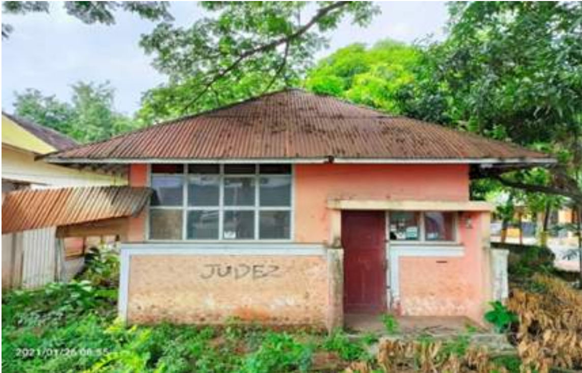
Foto Bangunan Kantor Pos Lama yang saat ini kondisinya terlantar sehingga banyak bagian pada bangunan ini yang telah mengalami kerusakan
