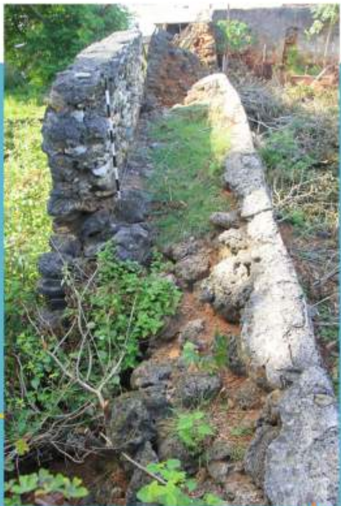
Foto. Kondisi dinding dan rumpuk benteng (Dok. BPCB Malut, 2017)
